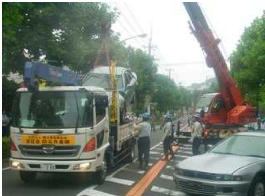
事故車両撤去
