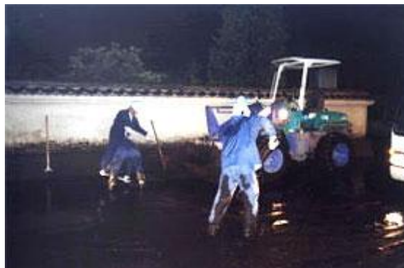
道路へ流出した土砂の片付け (神奈川県羽沢町)
